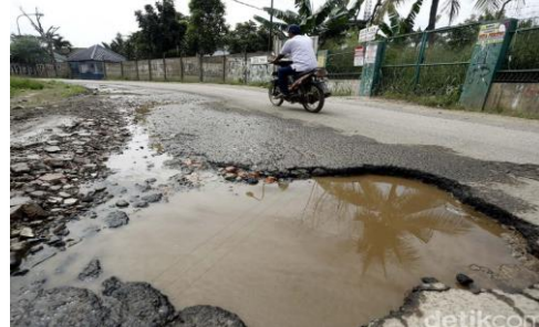
Gambar 5. Kondisi Jalan Aspal Maret 2018
