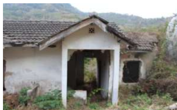
Gambar 2. Bangunan Rusak di Daerah Bukit Cula (Tampak Depan)
